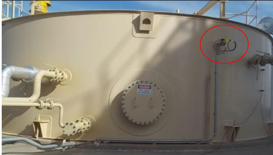
Figura 49- Telemetración del tanque
