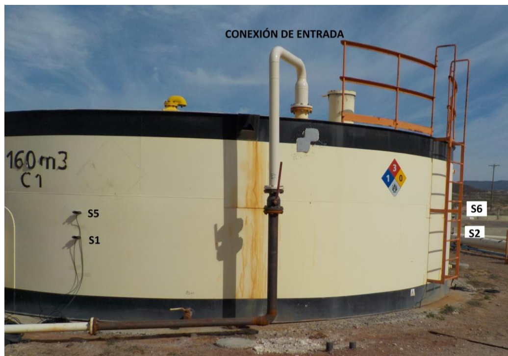
Figura 67- Línea de entrada de producto y distribución de sensores
