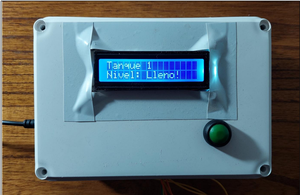
Figura 72: Visualización local del nivel de agua en el tanque 1.
