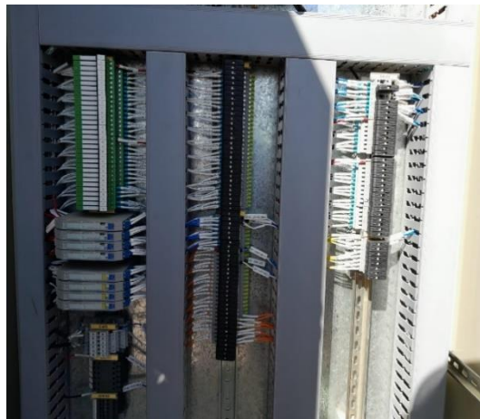
Figura 4.2 Borneras fronteras de módulos del PLC-alimentación de instrumentos
