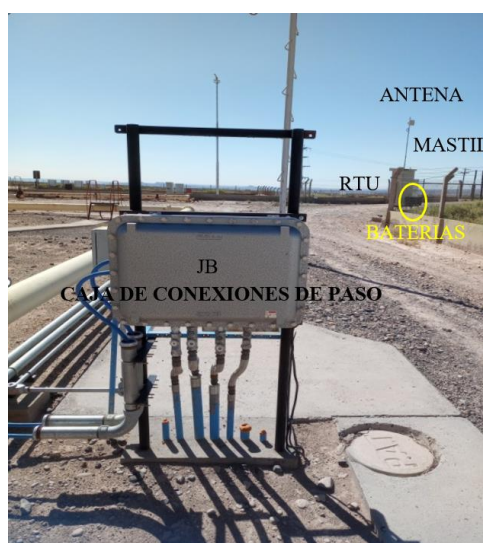
Figura 3.2 JB ubicada donde se encontraba la RTU antigua
