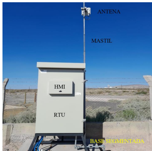
Figura 3.1 Base segmentada-RTU con sistema de comunicación mediante redline
