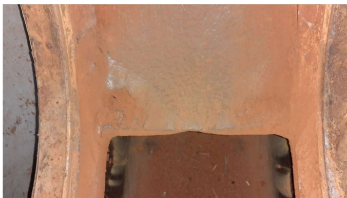
Imagen 36 - Daño por Presencia de Partículas Abrasivas en la Voluta
