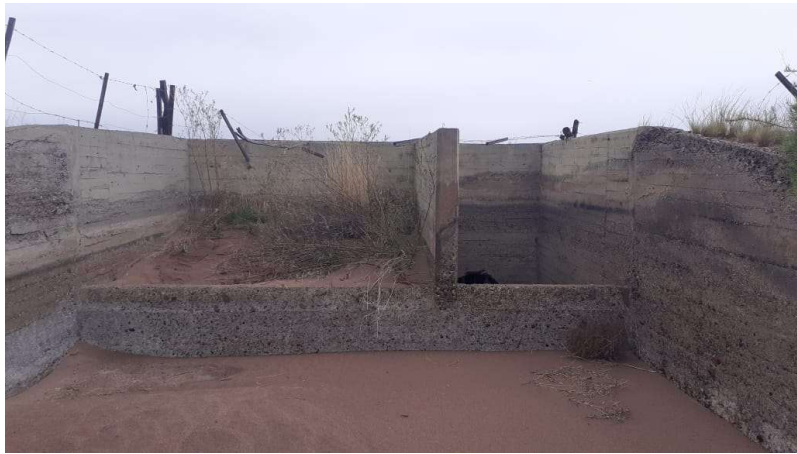
Imagen 17 - Vista Cámara de Descarga
