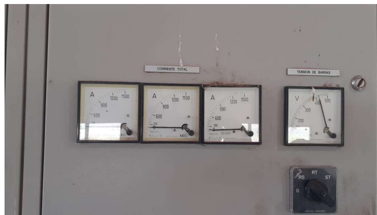
Imagen 19 - Tablero de Medidores
