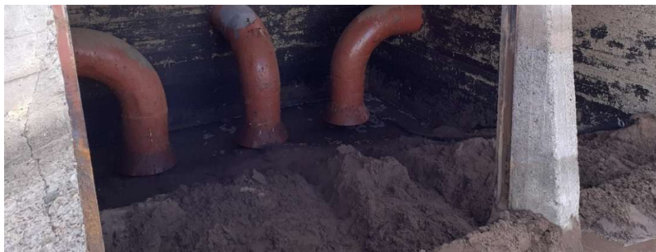
Imagen 14 - Cámara de Carga de Bombas
