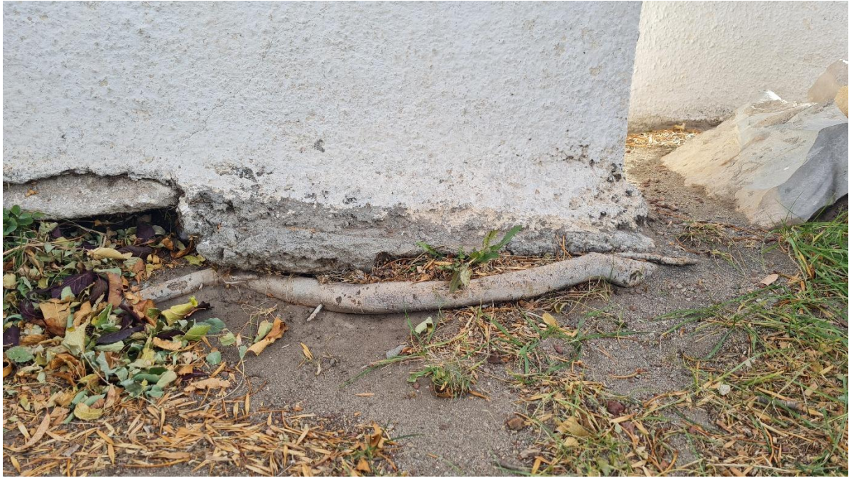
Raíces levantando el perímetro de concreto de la plaza.
