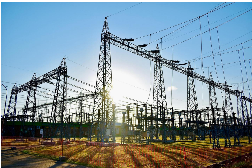
Figura 15: Estación transformadora de Alta tensión.
