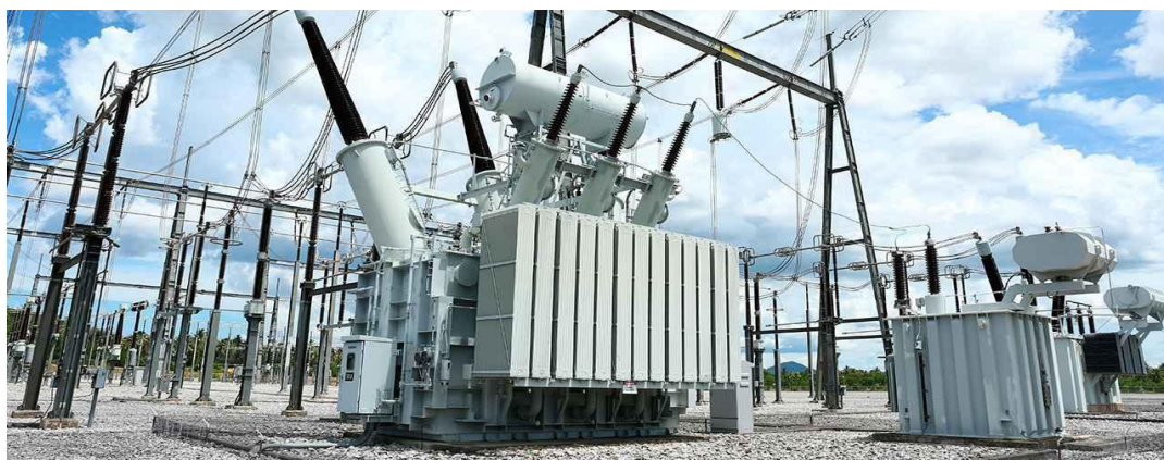
Figura 16: Transformador de potencia de Alta tensión.
