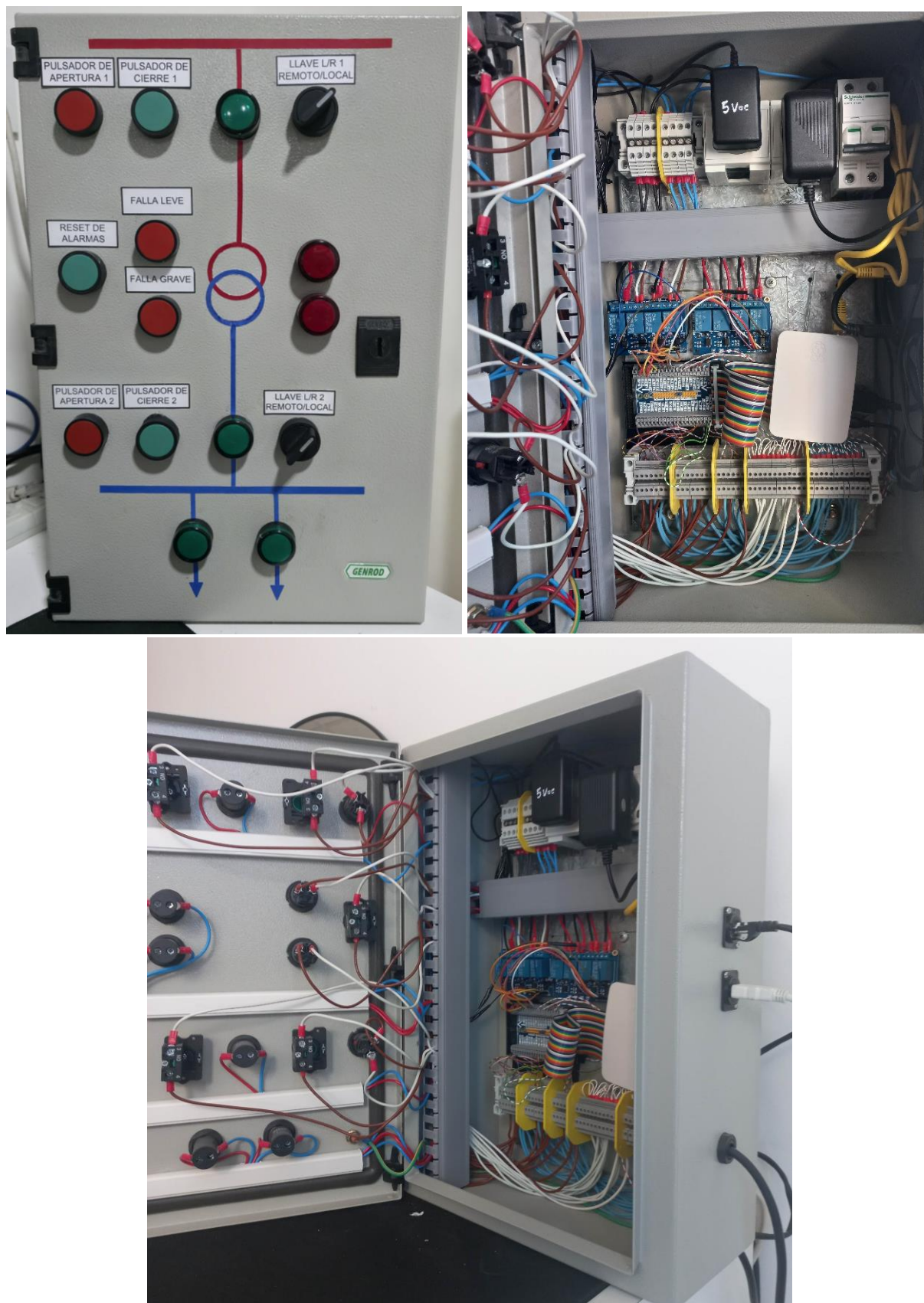
Figura 48: Tablero de comando finalizado.
