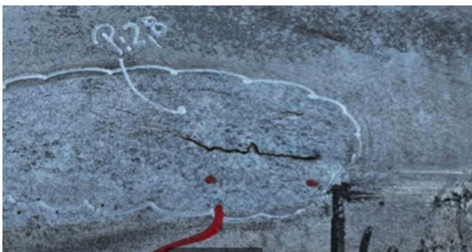
Figura 10: Hook crack encontrado en campo, saliente a la superficie exterior.
