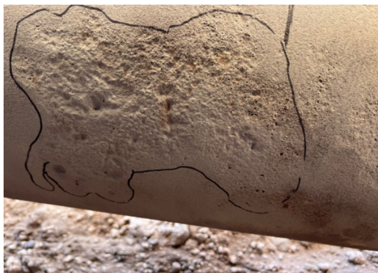
Figura 21: Evidencia de campo de corrosión generalizada.
