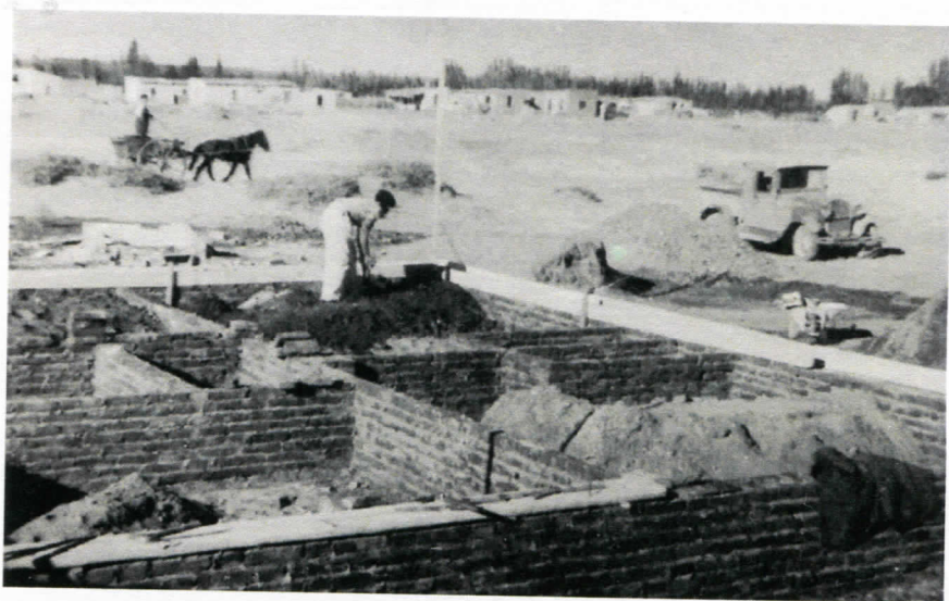
Construyendo la casa propia. Félix San Martín al 500. Primera casa de la cuadra. Mensura el Ingeniero Salvatori, padre del futuro gobernador. El carro con caballo va por donde cruzaría después la Ruta 22
