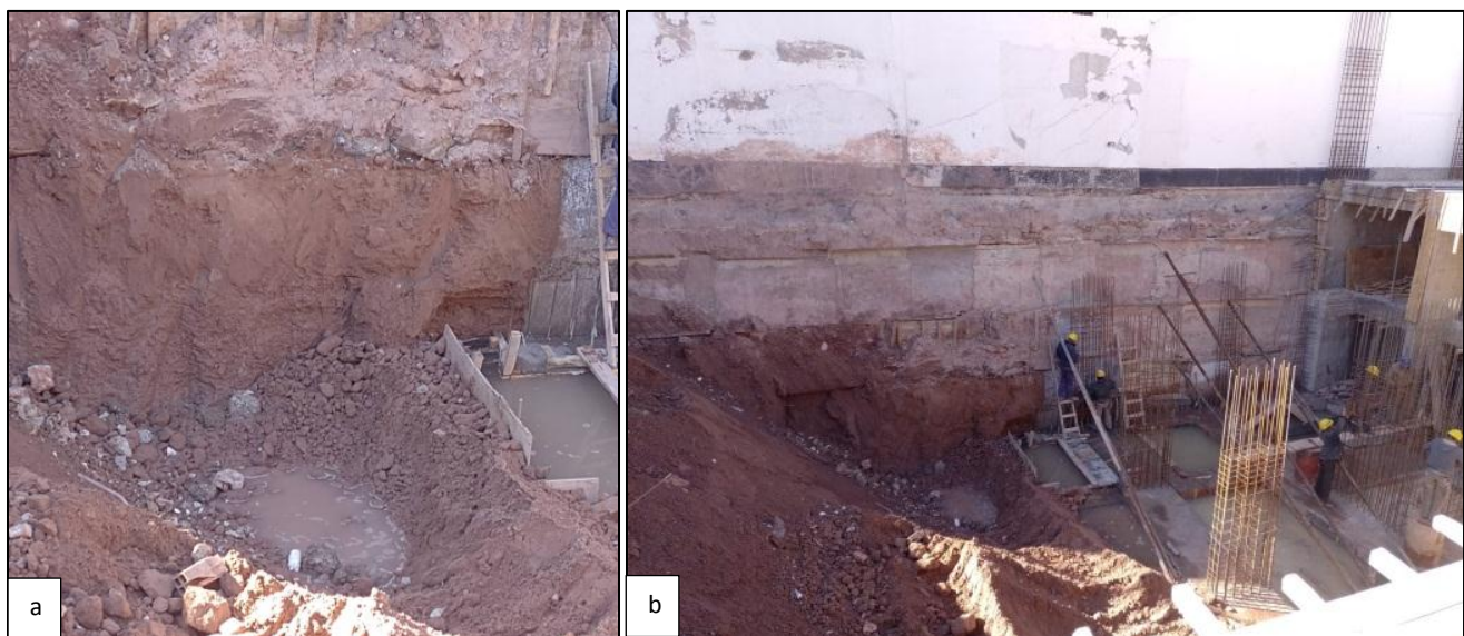
Figura 29. a) Litología expuesta en excavación. b) Presencia de filtraciones.
