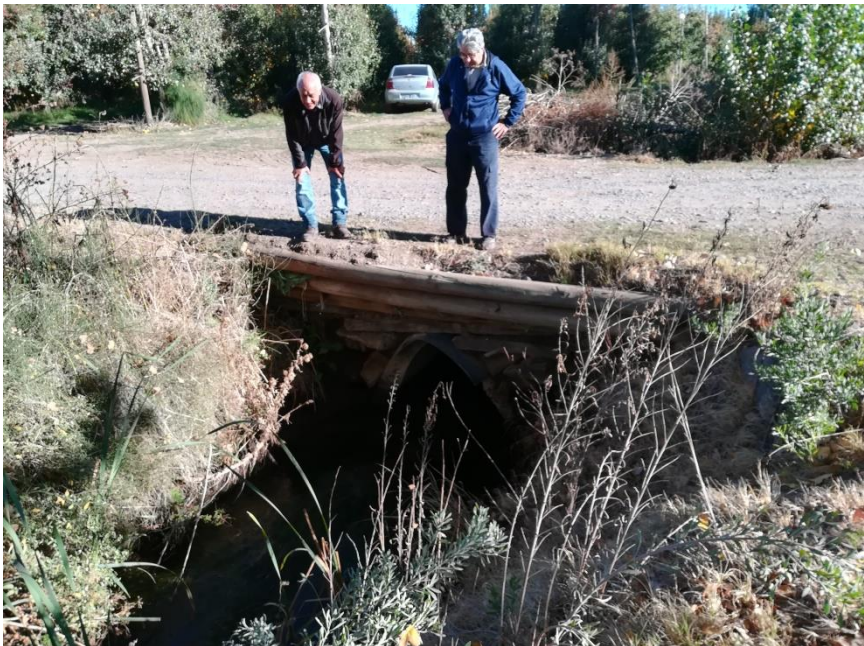
Figura 3: Técnicos del DPA y el Consorcio evaluando el estado de uno de los puentes, identificados en el recorrido como puntos críticos
