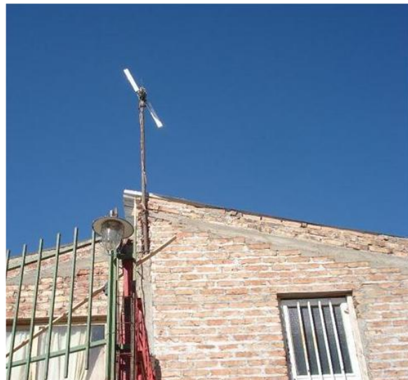
Figura 1.2: Pequeño aerogenerador de 150 W, instalado en una vivienda rural aislada en la zona de Planicie Banderita-Loma de La Lata, en el marco del proyecto del voluntariado
