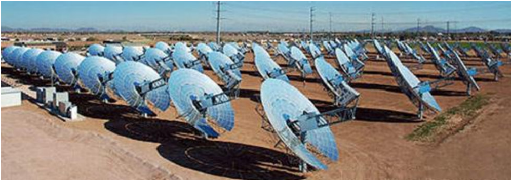
Figura 14.38: Planta Solar Maricopa. Peoria, Arizona, Estados Unidos. Fuente: Power Technology (Morrone CSP; 2019).
