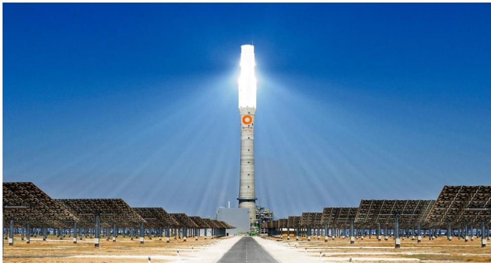
Figura 14.35: Planta Solar Gemasolar. Andalucía. España. Fuente: Torresol Energy (Morrone CSP; 2019).
