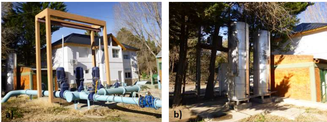
Figura Nº 23: a) BOMBAS DE 85 HP SOBRE CISTERNA DE LA PLANTA GRANDE. b) SISTEMA DE PROTECCIÓN ANTIARRIETE
