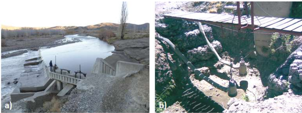
Figura Nº 19: a) OBRA DE TOMA CANAL NORTE b) ELECTROBOMBAS SUMERGIBLES TOMA DE SEGURIDAD
