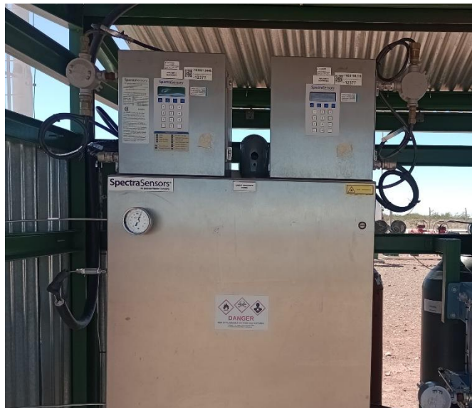
Figura 4.6: ‘Analizador de gas TDLAS J22 instalado en exteriores’.
