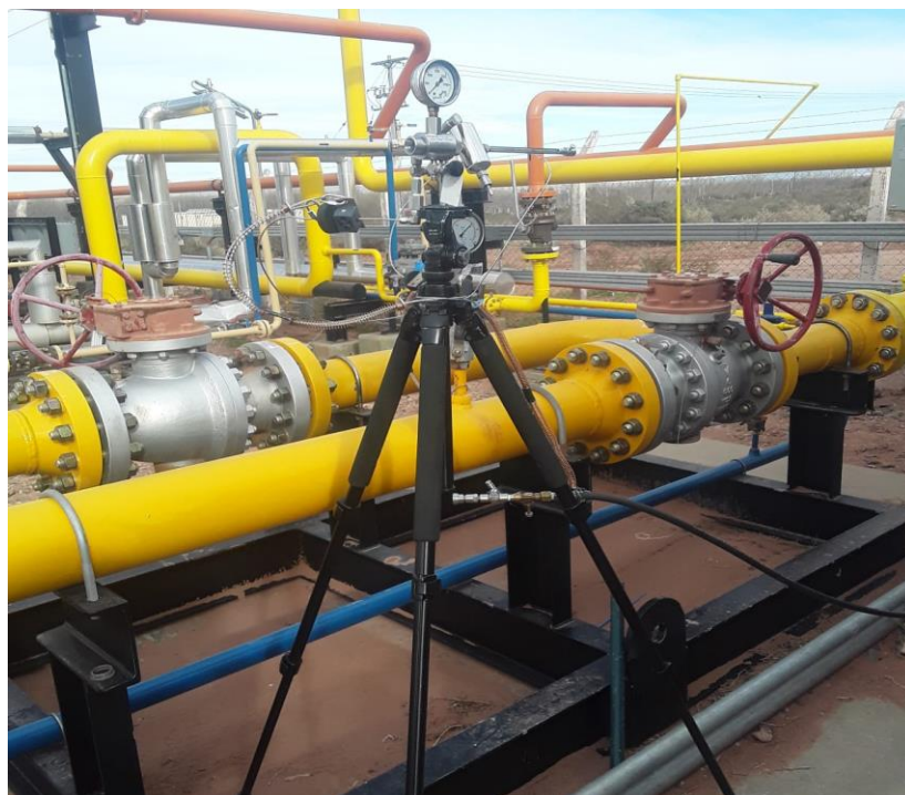
Figura 5.2: ‘Medición con Bureau of Mines a la salida de la planta’.
