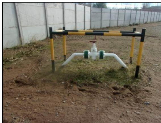
Figura 38: Colocar cartelera de riesgo a la instalación de superficie.
