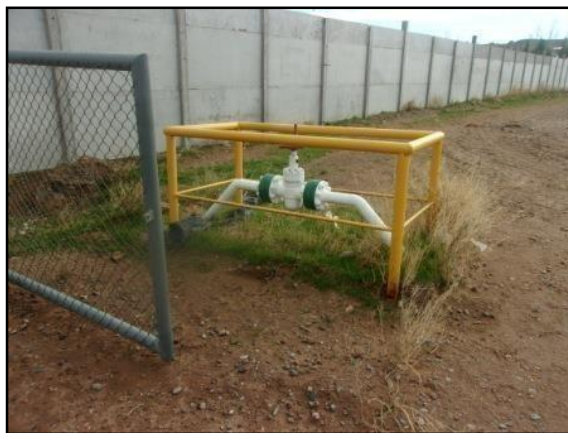
Figura 36: Colocar cartelera de riesgo a la instalación de superficie.
