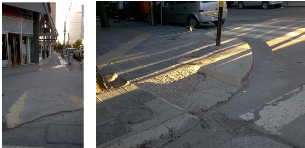
Foto 13. Rampas deterioradas Centro Nqn
