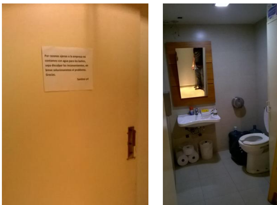
Foto 41. Sanitario usado como depósito Fuente: M. B. Arce. Santino. 23/04/2016
