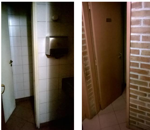
Foto 40. Sanitarios no accesibles Confitería El Ciervo Fuente: M. B. Arce. 24/03/2016
