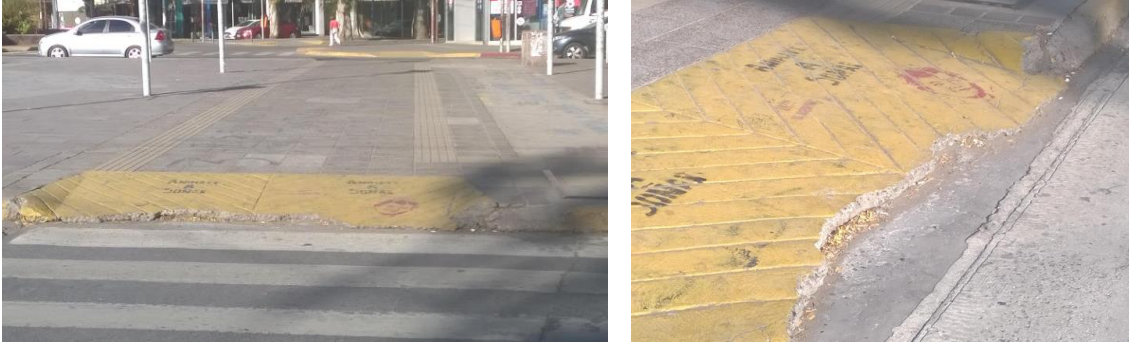
Rampa con roturas
