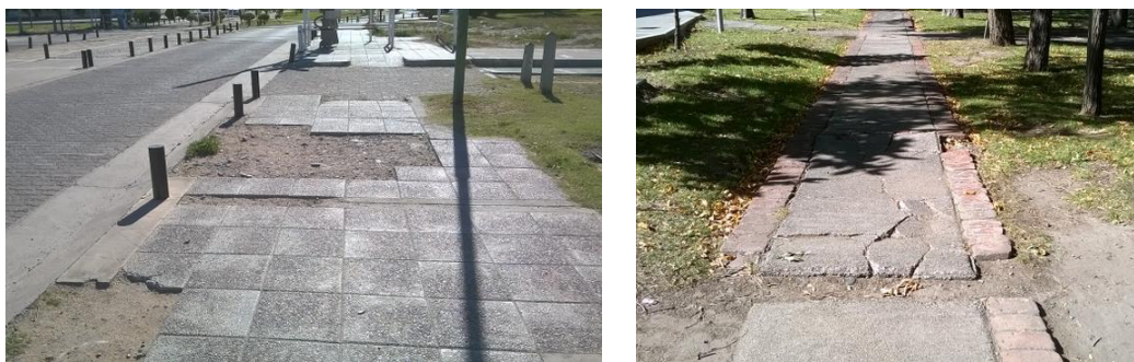
Foto 56. Veredas deterioradas Parque Central
