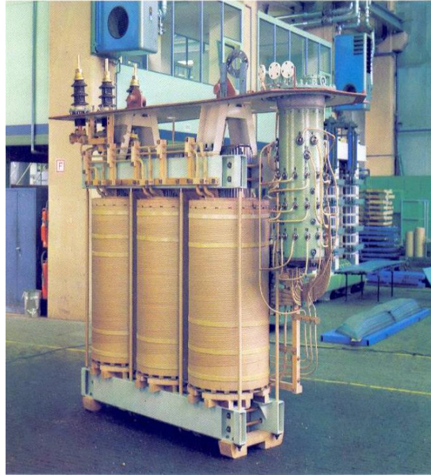
Figura 1.12-Vista de un cambiador de tomas bajo carga montado en el transformador.
