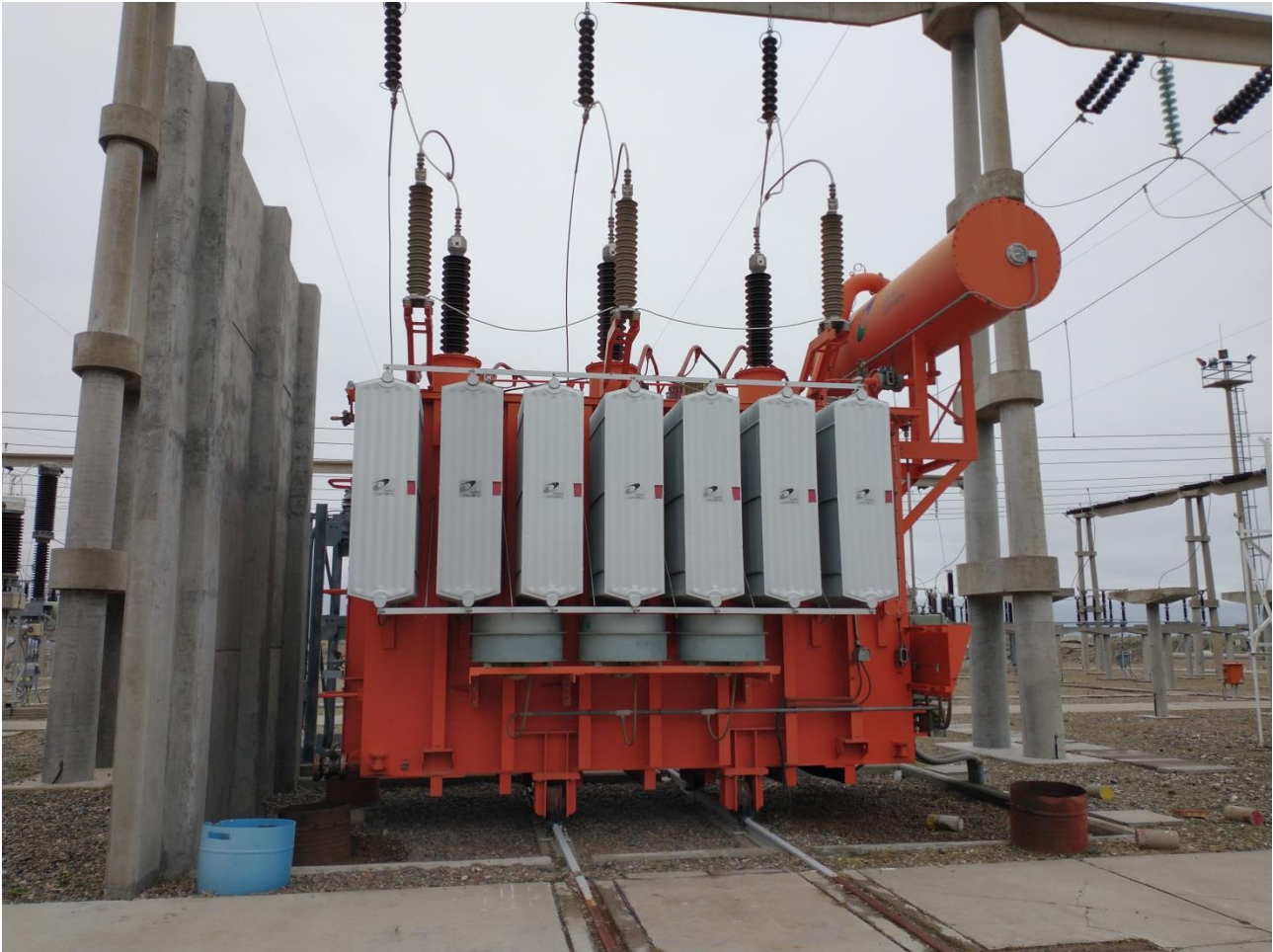
Figura 3.1-Transformador de potencia 132/33/13.2 kV 45 MVA.
