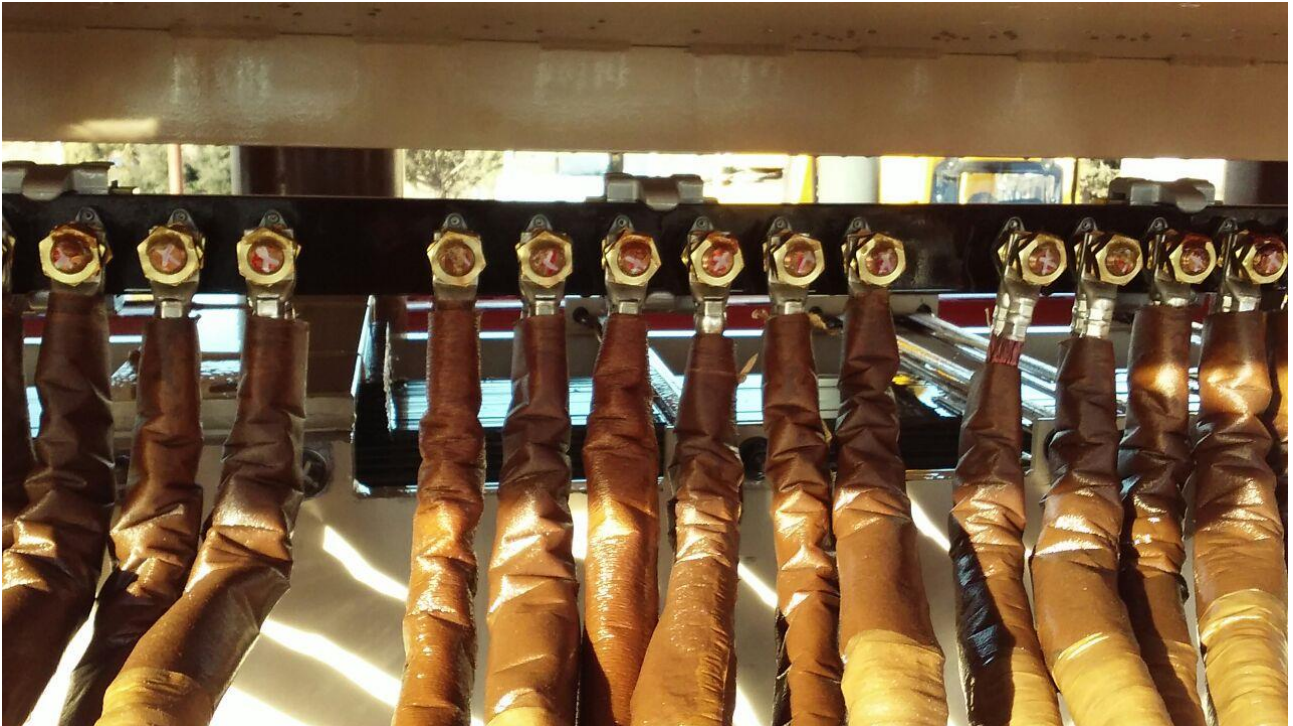
Figura 3.9-Vista del regulador sin carga. Arrollamiento de 33 kV.
