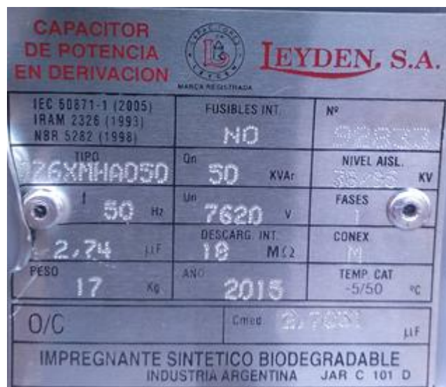
Figura 3.14-Capacitor utilizado para limpieza del núcleo.
