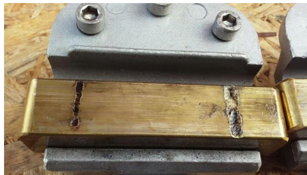
Figura 3.10-Contacto móvil de RSC. Se observan vestigios de arcos eléctricos.
