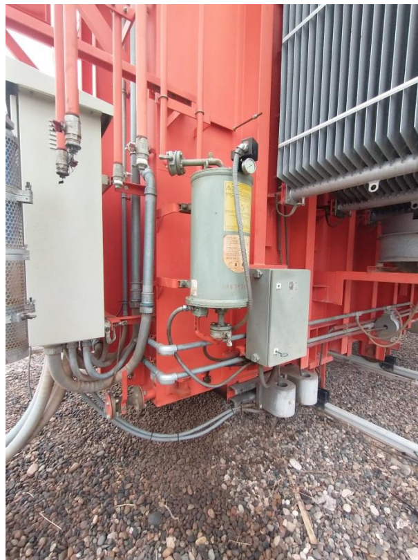
Figura 1.13-Vista de un equipo de filtrado de aceite del RBC con su tablero de comando a la derecha.
