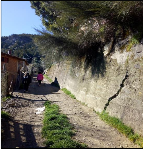
Imagen 61: Evidencia de colapso en muro de hormigón.
