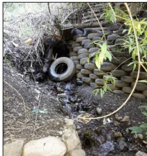
Imagen 60: Misma fotografía año 2019 con material de relleno. Contención con cubiertas y obstrucción del cauce del arroyo.
