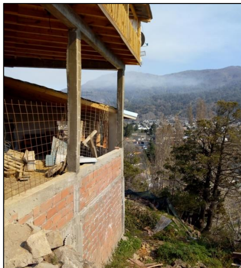
Imagen 29: Vivienda de hormigón en construcción al pie de ladera con tres (3) niveles.
