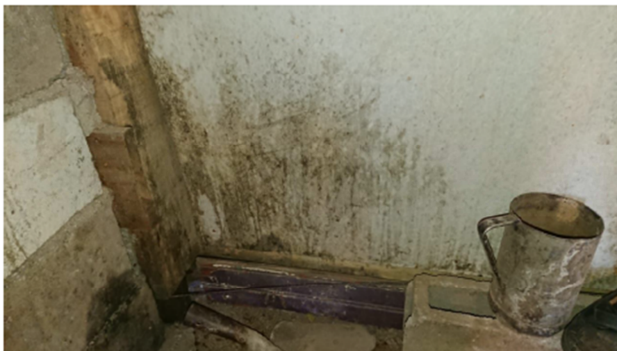
Imagen 3.10 - Colonia de hongos en la vivienda 7. Fuente: Documentación provista por TECHO.
