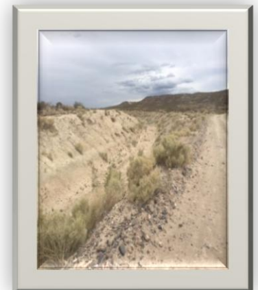
En la foto se observa la falta de mantenimiento del Canal Trasvase
