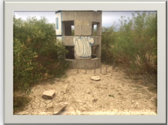
En la foto se observan las obstrucciones laterales en la torre de toma por falta de mantenimiento
