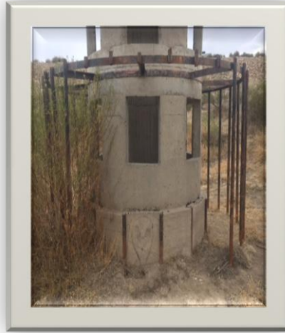
En la foto se observa el efecto del vandalismo en las rejas de protección de la torres de los descargadores de fondo del Dique Roca.
