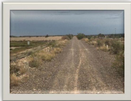
En la foto se observa la falta de mantenimiento en el coronamiento del Dique Catini
