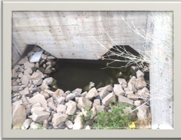
En la foto se observa el amortiguador de flujo en la salida de los descargadores de fondo del Dique Catini-Parcialmente Obstruida
