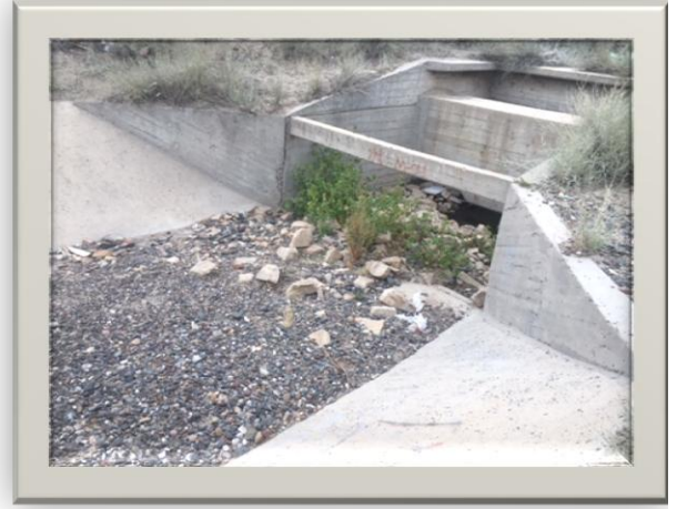
En la foto se observa la falta de mantenimiento en la estructura de amortiguación de salida del descargador de fondo del Dique Catini
