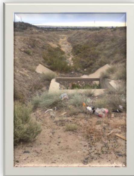
En la foto se observa la falta de mantenimiento en el Canal de Salida del Dique Catini ( Desagüe).
