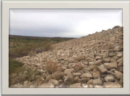
En la foto se puede observar la falta de mantenimiento en los espaldones aguas arriba del Dique Roca
