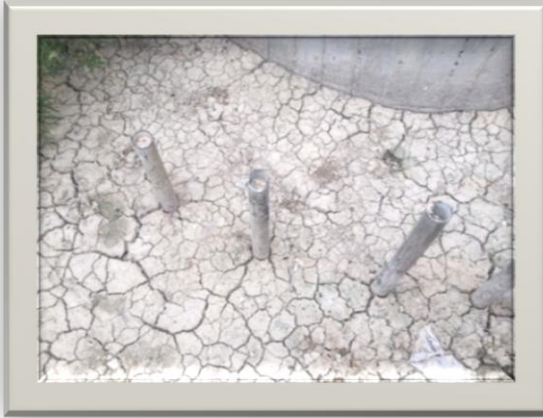
En la foto se observa el efecto del vandalismo en las rejas de la torre de toma de los descargadores de fondo del Dique Catini
