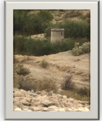
En la foto se observan las obstrucciones de malezas en la torre 2 de los descargadores de fondo del Dique Roca.
