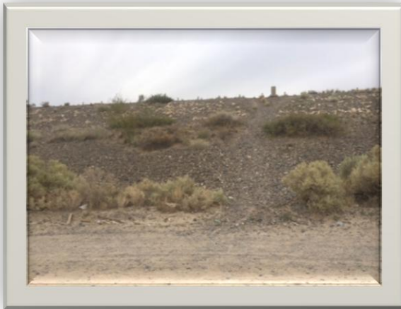
En la foto se observa la falta de mantenimiento en el espaldones aguas abajo del Dique Catini y la Actividad Antrópica sobre el mismo.
