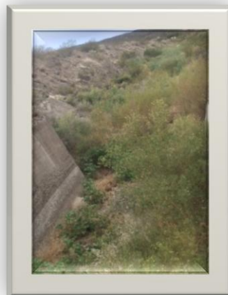
En la foto se observa la falta de mantenimiento en la salida de los descargadores de fondo del Dique Roca
