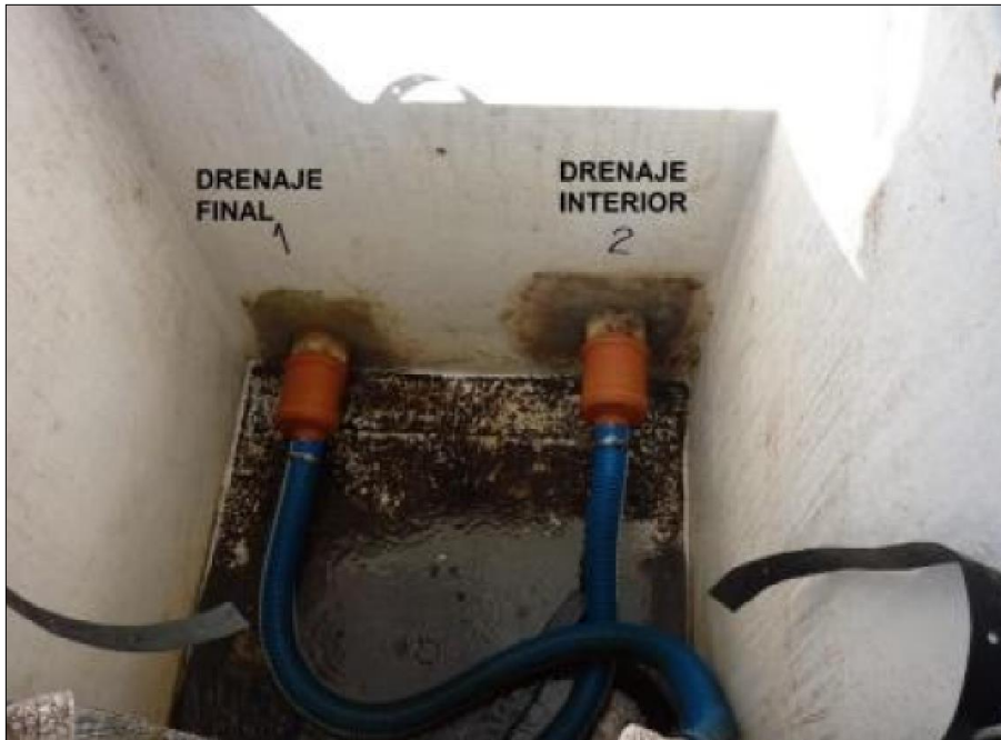
Figura N° 11: Cámara de salida
